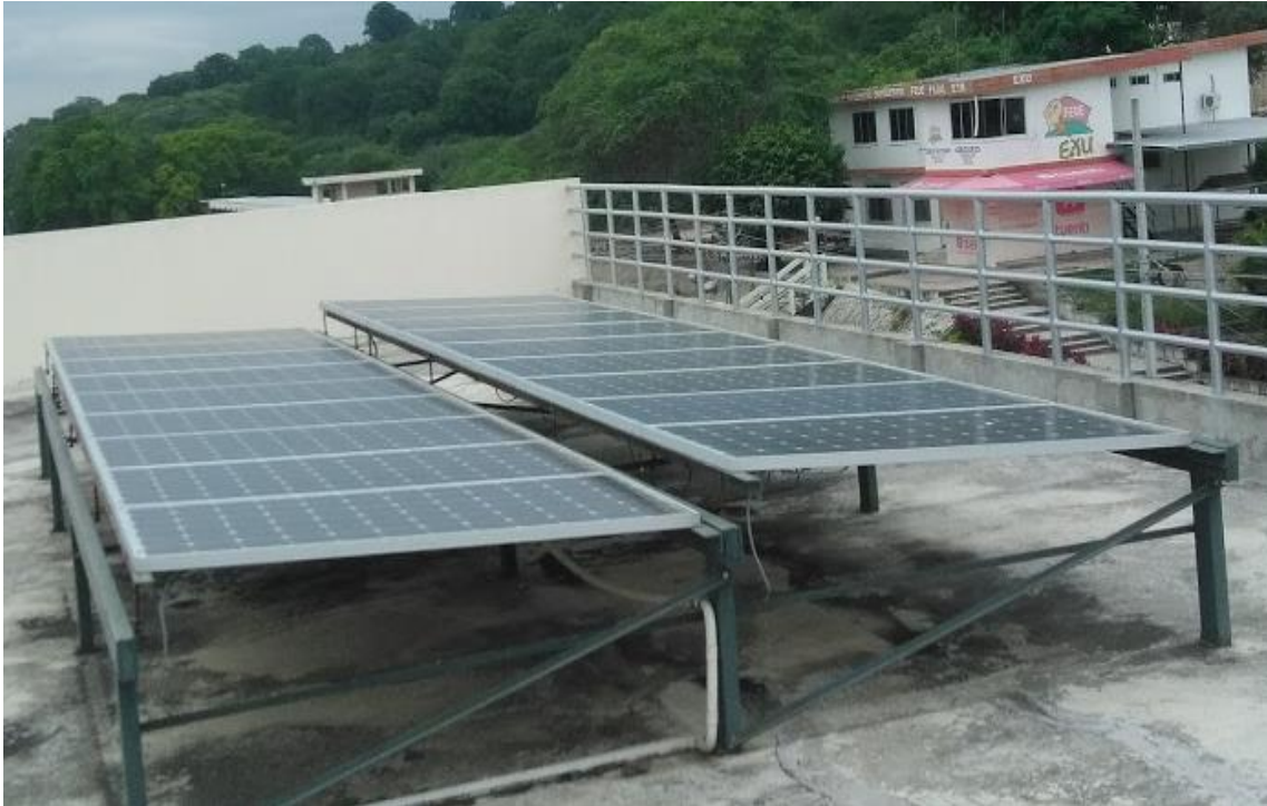
Figura 19. Módulos de silicio que conforman la mini-central fotovoltaica.
