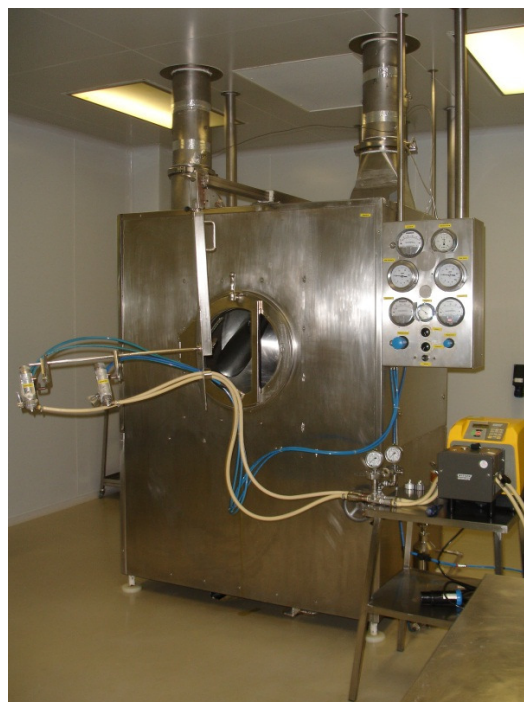
Figura 2.3- Máquina de revestimento de comprimidos do FSO1
