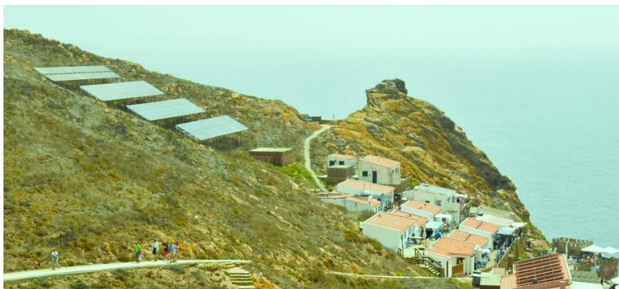
Figura 11: Painéis fotovoltaicos do Bairro dos Pescadores (canto superior esquerdo) e do Restaurante “Mesa da Ilha” (centro inferior).
