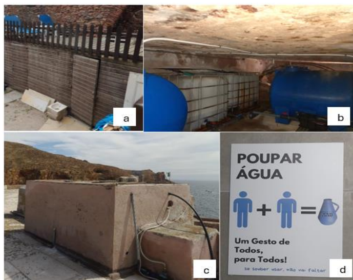
Figura 15: Local onde é feita a dessalinização d'água no Forte (a), o seu interior (b), a localização do depósito para água doce (c) e avisos à sensibilização do consumo da água no forte (d), presentes tanto nas casas de banho partilhadas, como na cozinha do staff .
