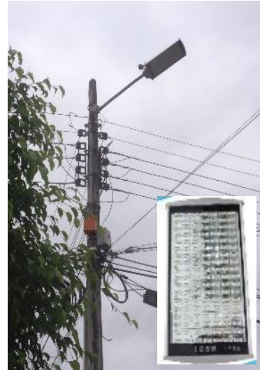
Figura 40-Luminaria LED (Elaboración propia)
