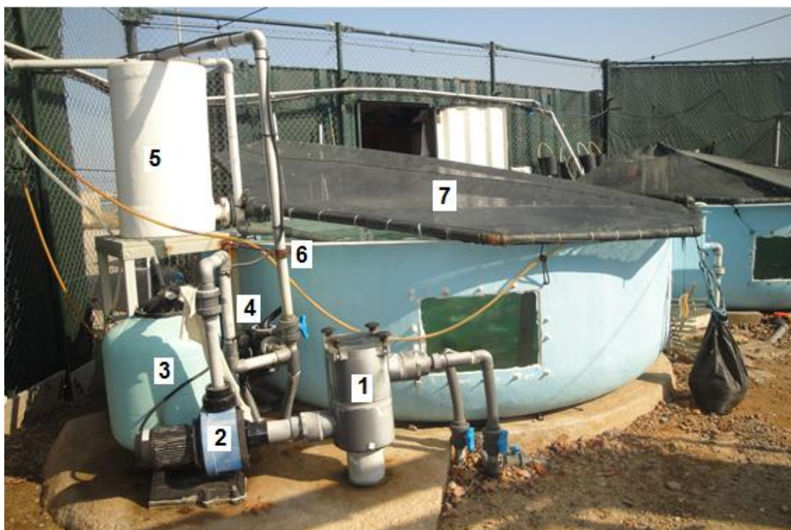
Figura 9. Tanque Norte. 1-pré-filtro, 2-bomba externa, 3-filtro de areia, 4- mono-válvula, 5- bio-filtro, 6- entrada de água nova, 7- cobertura amovível
