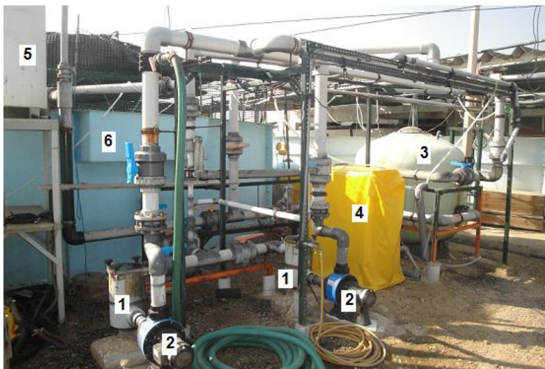
Figura 11. Tanque Central. 1- pré-filtro, 2- bomba externa, 3-filtro de areia, 4- filtro ultra-violeta, 5- bio-filtro, 6- Skimmer de superfície.
