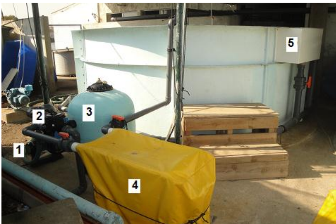
Figura 10. Tanque Oeste. 1- bomba externa, 2- mono-válvula, 3-filtro de areia, 4- filtro ultravioleta, 5- skimmer de superfície.
