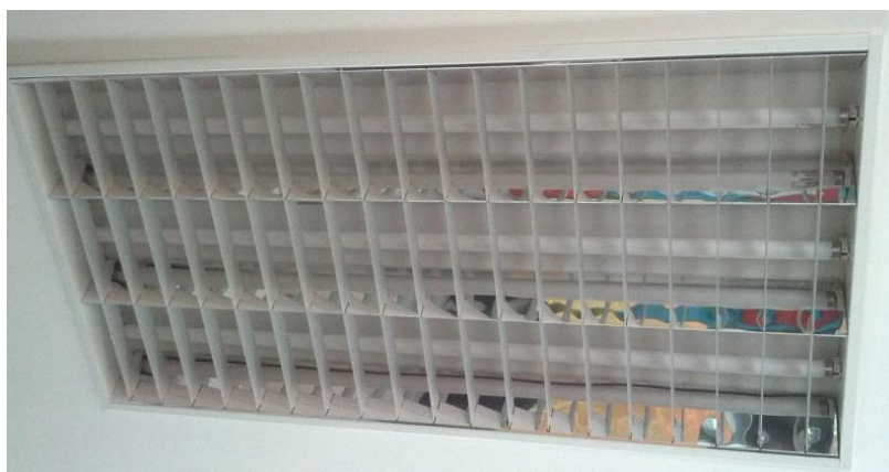
Figura 12-Luminárias da sala administrativa e da recepção
