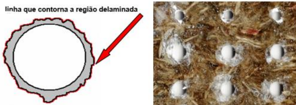
Figura 57 - (Esq.) Representação esquemática da imagem da área do furo, da área delaminada e da linha de contorno da área delaminada; (Dir.) Pormenor da placa com as zonas delaminadas.
