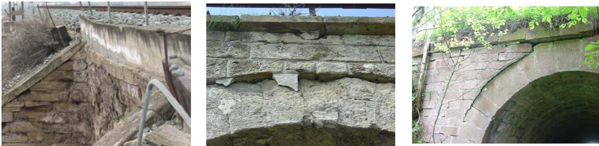
Figura 31. Abaulamento [esq.], destacamento [centro], rotação do muro [dir.] (Lopes, 2012)
