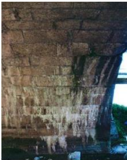
Figura 33. Presença de eflorescências e escorrências de água no intradorso da ponte (Rodrigues, 2004)
