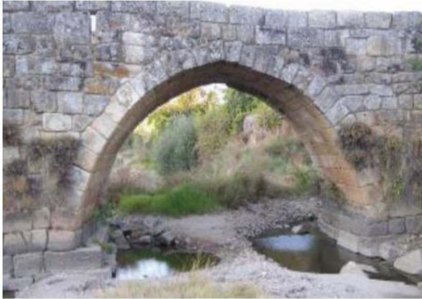
Figura 30. Abatimento do arco e fendilhação na base (Ramos, et al.)
