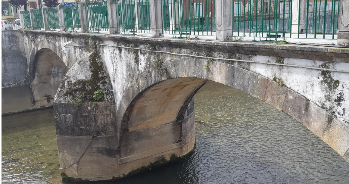
Figura 43. Anomalias não-estruturais (alçado a montante)
