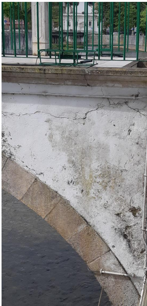
Figura 44. Fissuração do material de revestimento (alçado a montante)
