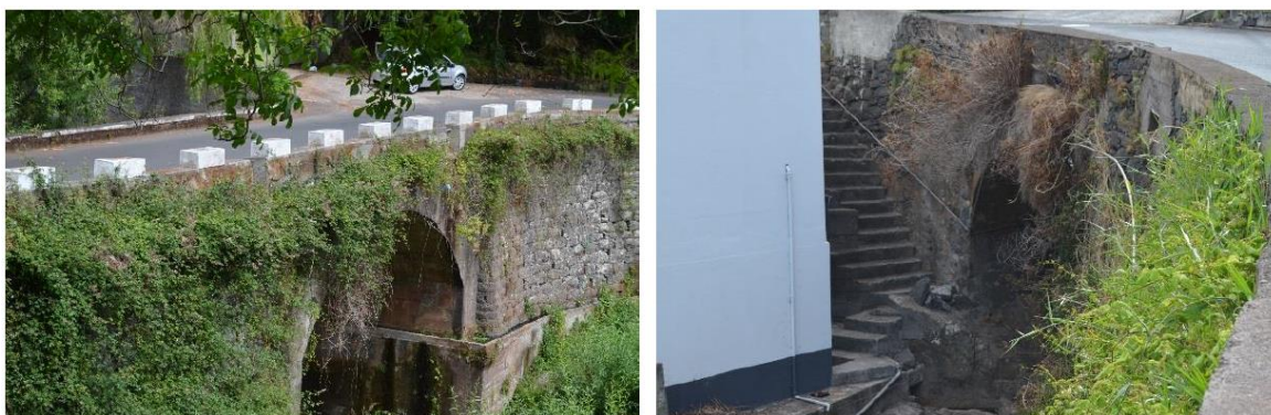
Figura 34. Vegetação presente nas estruturas de alvenaria de pedra (Rodrigues, 2014)
