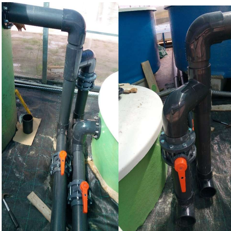
Figura 35 – Válvulas que permitem a separação dos circuitos.
