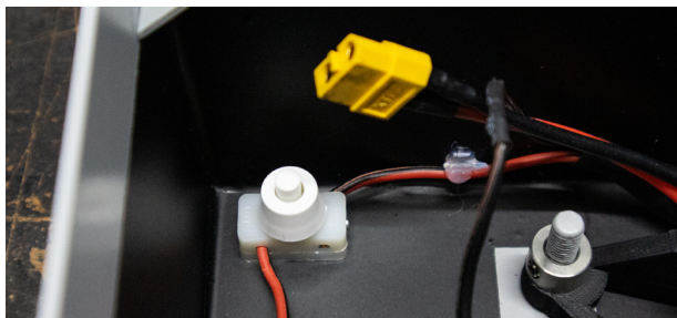
Figura 51_ Interruptor do circuito e cabo XT60 para recarregamento da bateria na câmara interior do Banco.
