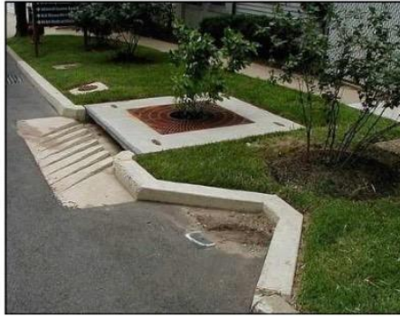
Figura 26 - Caldeira com sarjeta
