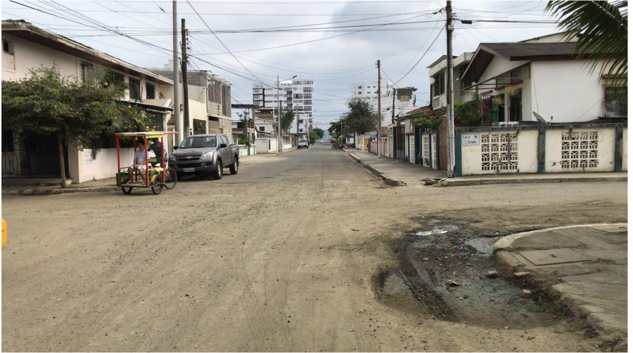
Figura 72. Estado de la calzada de la calle Cincinato Estrada. Foto autor
