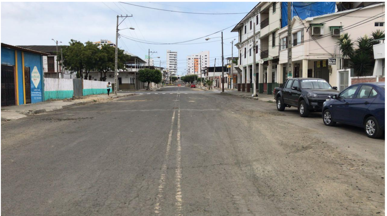
Figura 73. Estado de la calzada de la calle Checa. Foto autor
