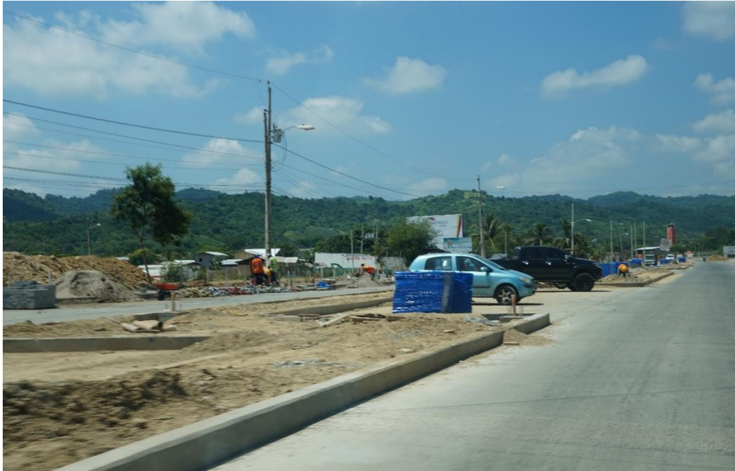
Figura 35. Parqueaderos en construcción en forma de batería, Parroquia de Leonidas Plaza. Foto autor
