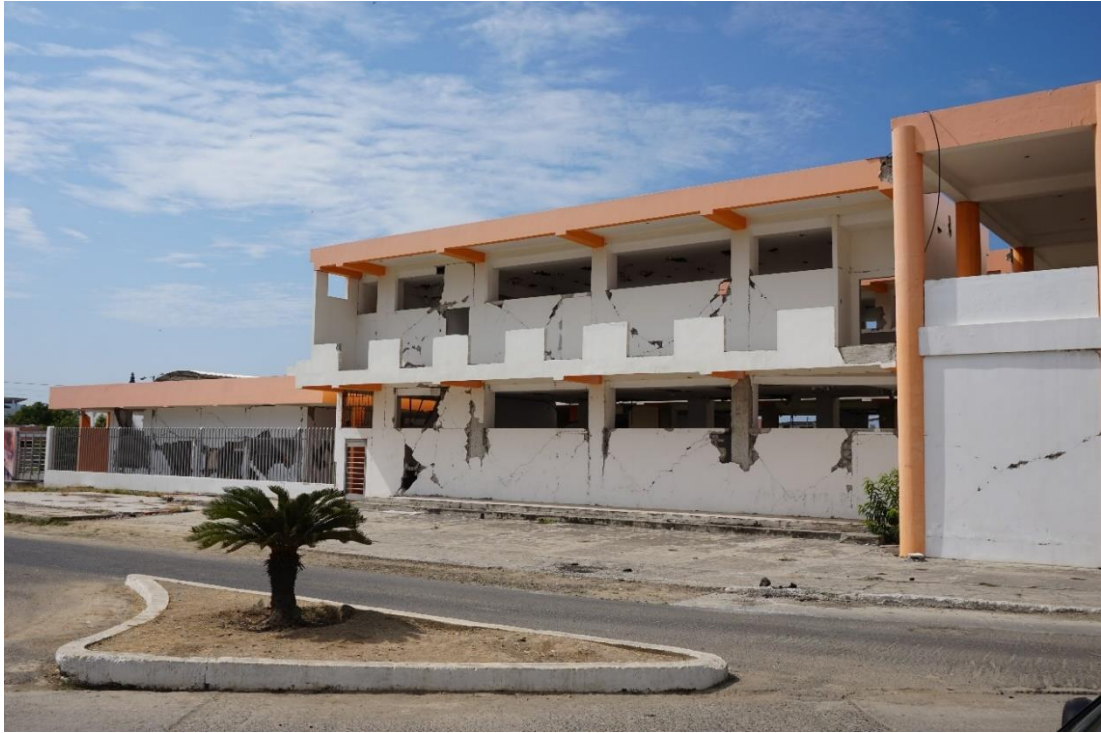
Figura 82. Afectaciones del terremoto del 16 de abril del 2016 en instituciones educativas. Foto autor
