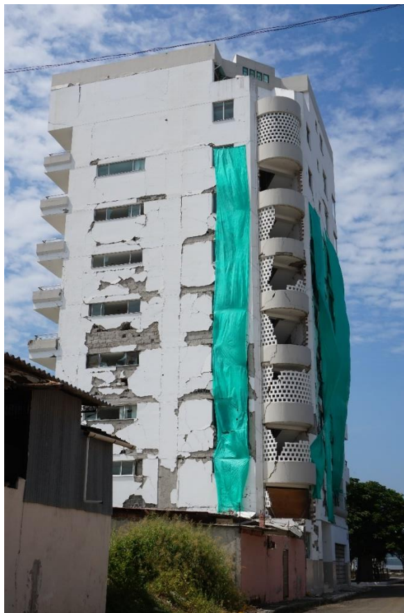
Figura 83. Afectaciones del terremoto del 16 de abril del 2016 en el sector hotelero. Foto autor
