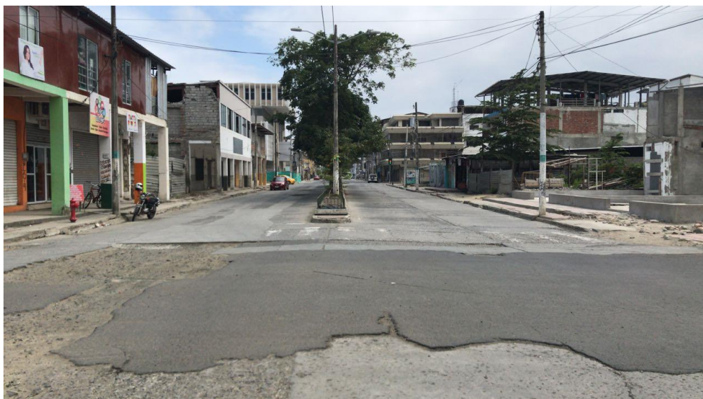
Figura 71. Estado de la calzada de la Avenida Bolívar. Foto autor
