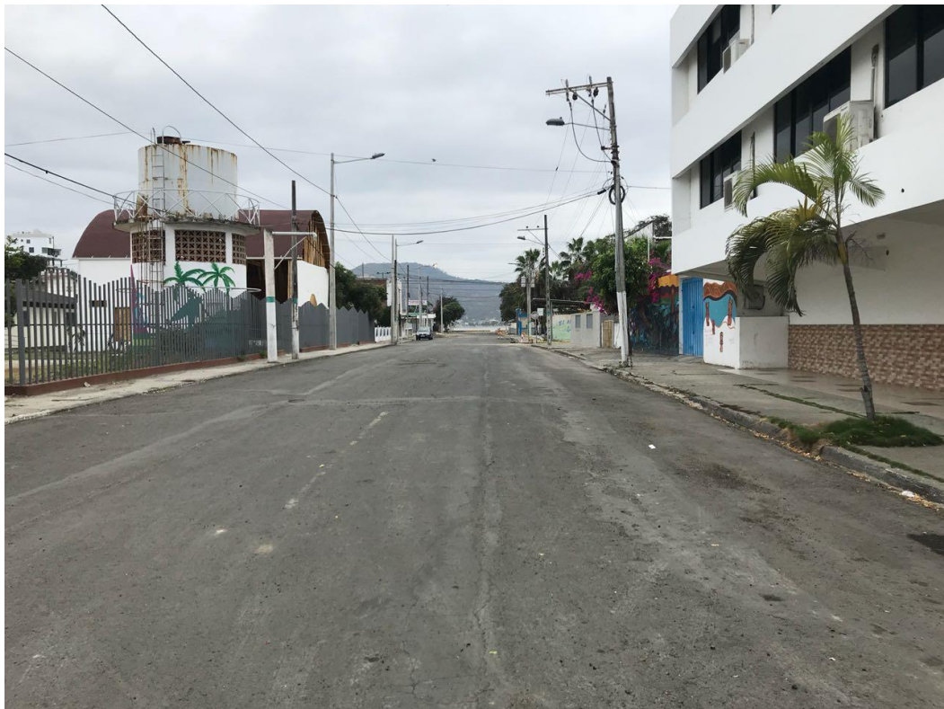
Figura 75. Estado de la calzada de la calle Mateus. Foto autor
