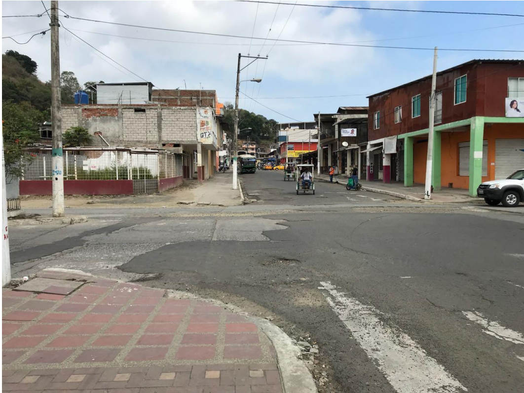
Figura 74. Estado de la calzada de la calla Ante. Foto autor
