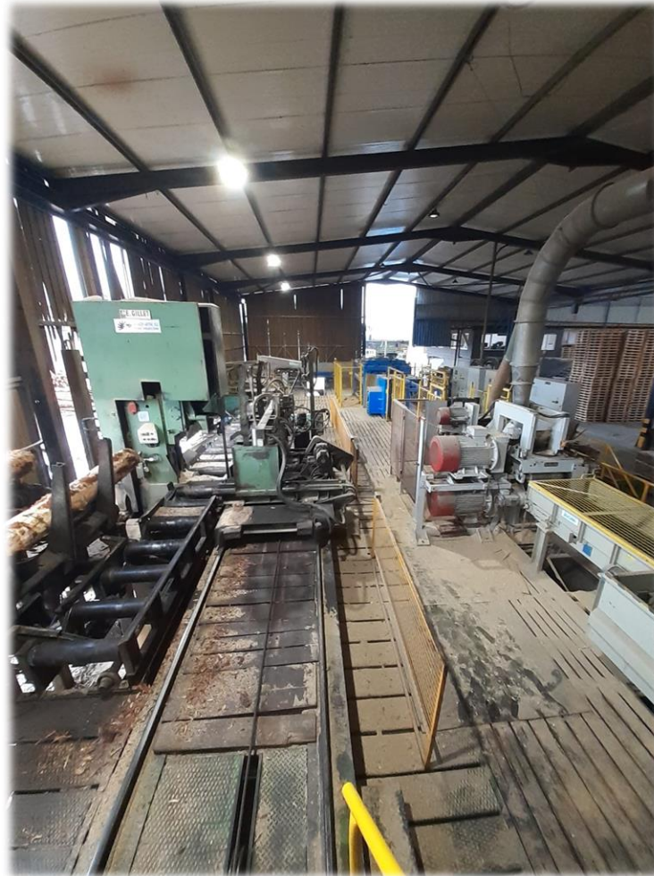
Figura 6 - Vista geral da linha de serragem
