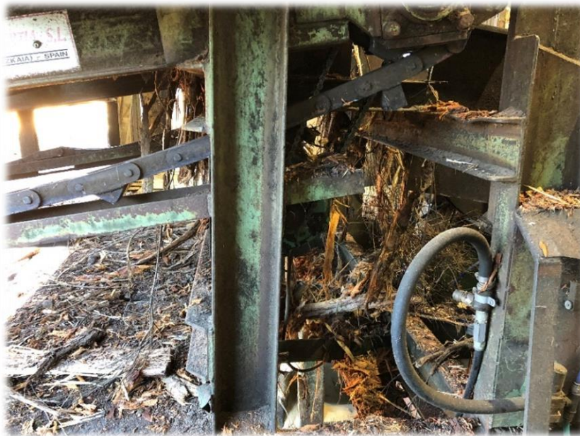
Figura 23 - Acumulação de resíduos nas correntes
