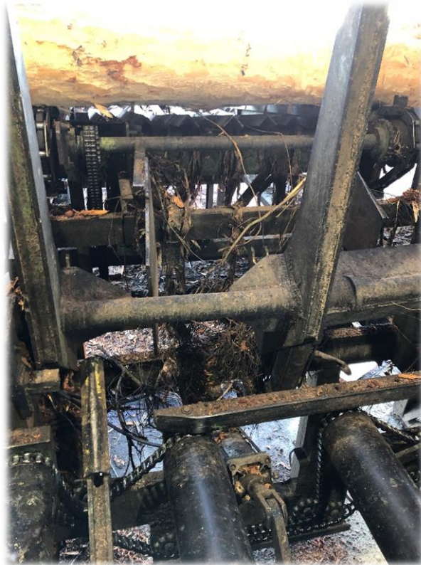
Figura 24 - Acumulação de resíduos nos transportadores
