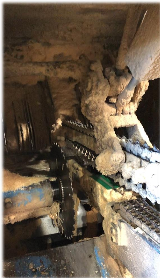
Figura 20 - Acumulação de serradura na serra 3
