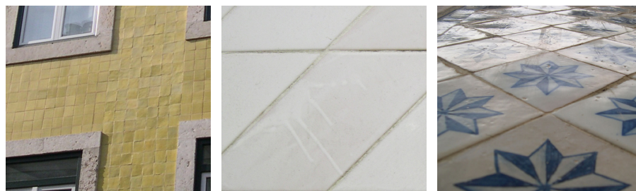
Fig. 23. Acção humana no revestimentos de azulejos: aplicação irregular, escorridos de vidração manual, irregularidade da superfície e da aplicação manual. Fotos da autora.
