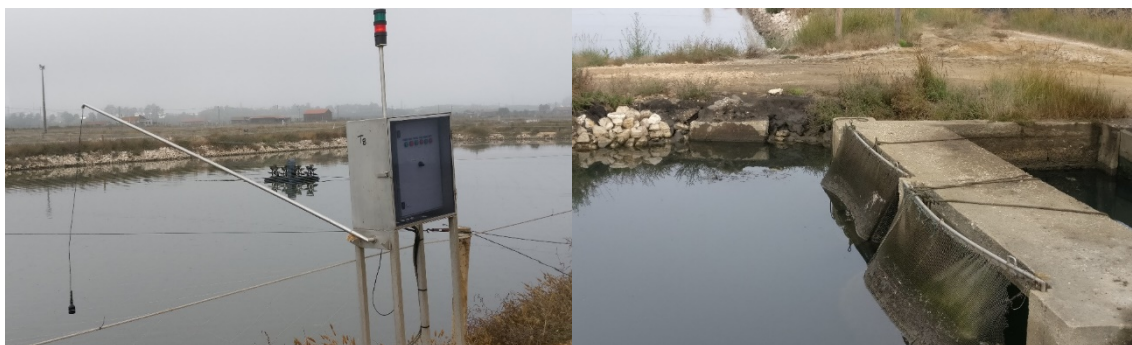
Fig. 3. a) Quadro de electricidade de um tanque e sonda de medição de temperatura e salinidade. b) Bitorões da vala de entrada da Piscicultura do Torrão.
