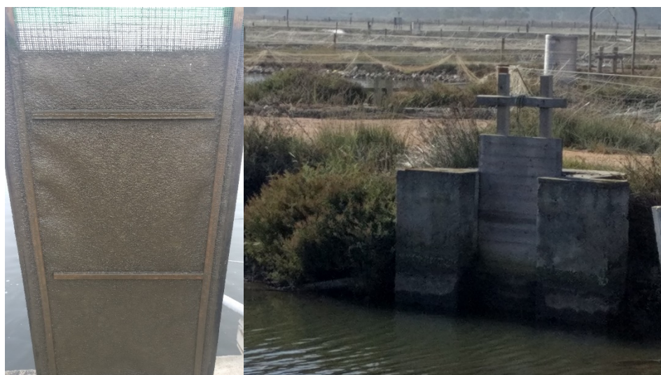
Fig. 8. a) Grade de protecção com biofouling. b) Porta de entrada/saída de um tanque.
