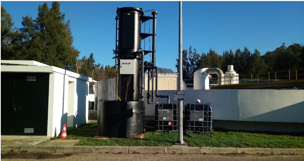
Figura 6.1 – Instalação do sistema CAFE na ETAR de Olhalvas
