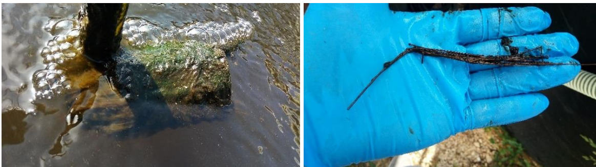
Figura 6.4 – Algas a envolver a bomba (à esquerda) e agulhas de cedro a colmatar o impulsor da bomba (à direita)
