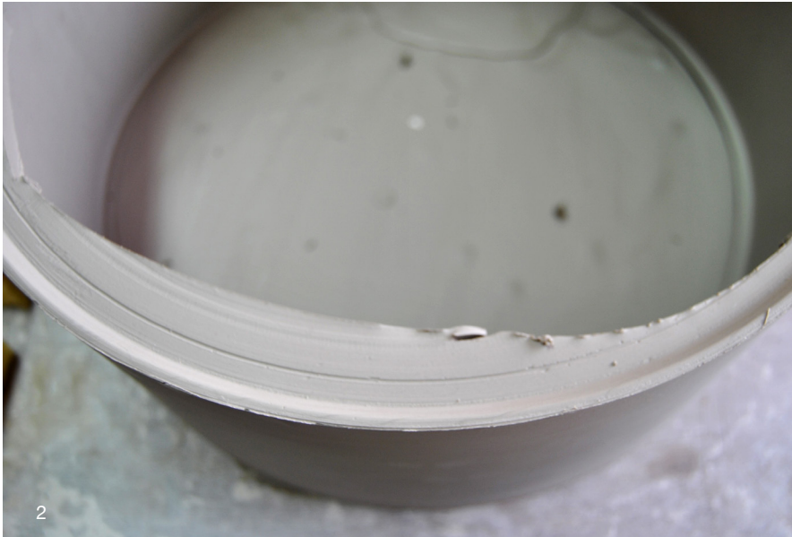
Fig. 2) Frame de cerâmica mal cortado
