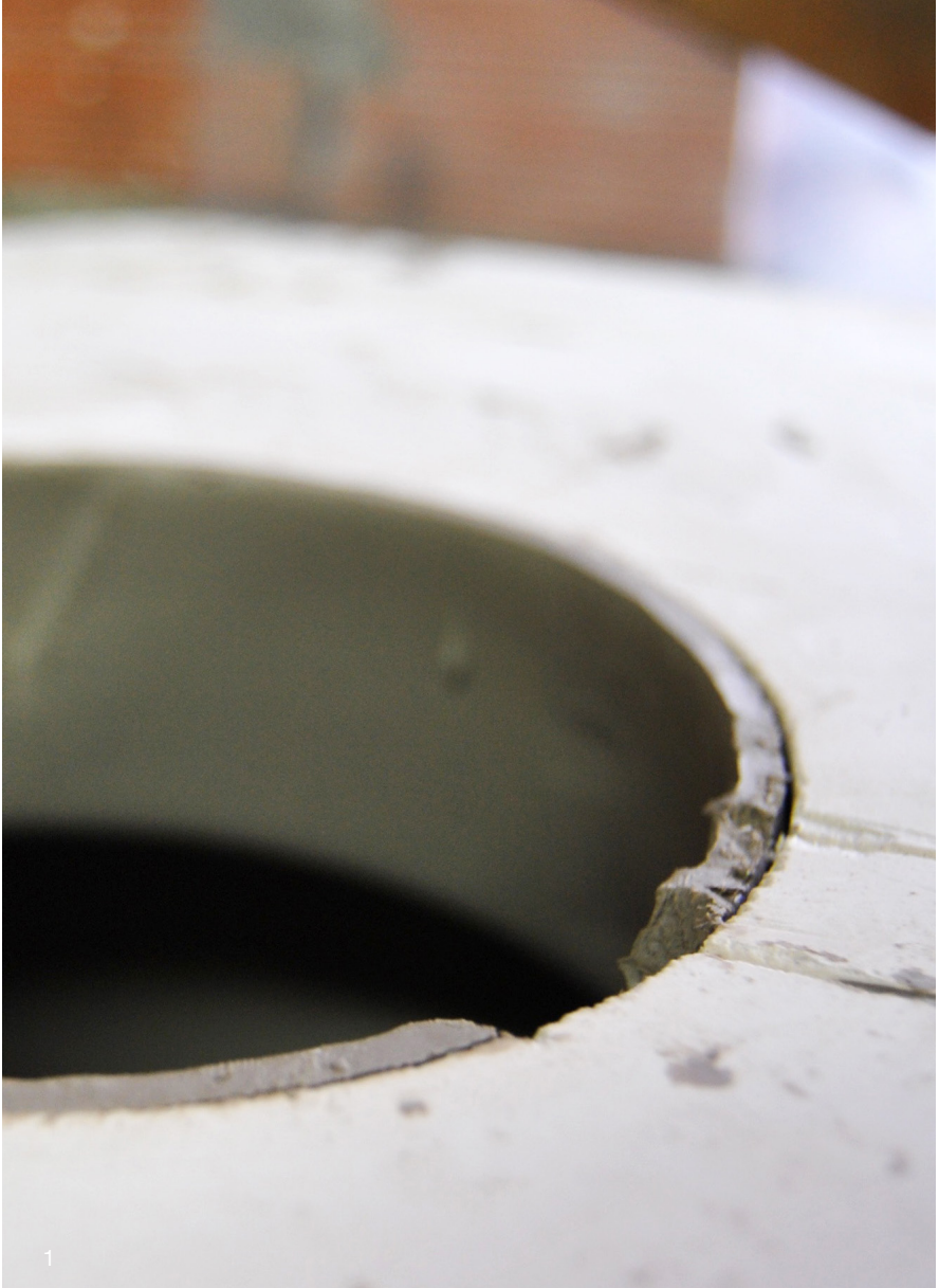
Fig. 1) Boca de enchimento
