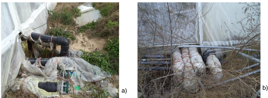
Figura 75 Entrada e saída de tubagem nas estufas: a) Estufas norte; b) Estufas sul (Fonte: O autor)
