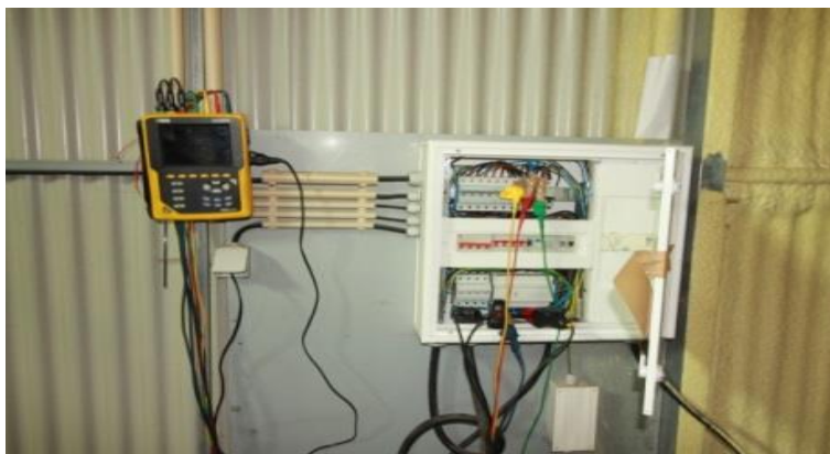
Figura 43 Recolha de consumos: analisador e quadro elétrico (Fonte: O autor)
