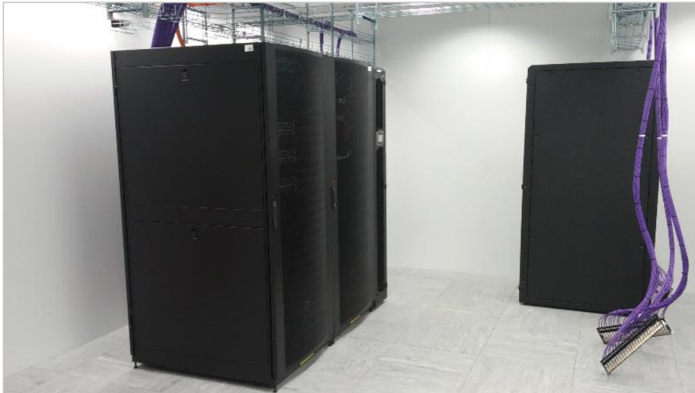
Figura 18 - Datacenter CHL, Direção do SSI do CHL
