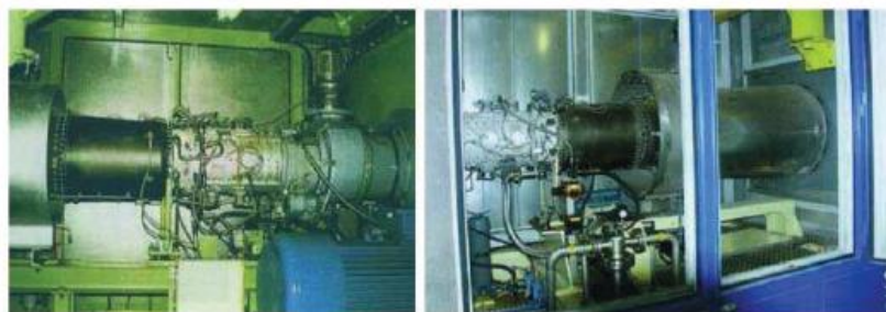
Figura 2. Turbina de gas de capacidad 4.6 MW y 3.4 MW
