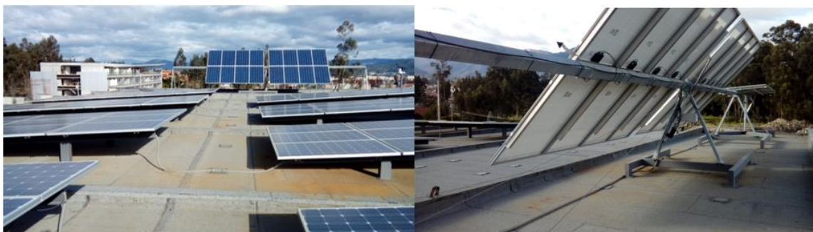
Figura 13. Arreglos de paneles solares Fotovoltaicos- Laboratorio Micro-red, U. de Cuenca.
