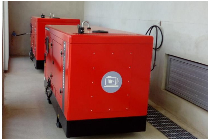
Figura 16. Grupo de Electr geno Di sel y Gas Natural – Laboratorio Micro-red, U. de Cuenca.
