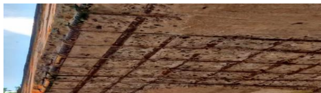
Figura 8 - Estrutura de betão degradada [22]
