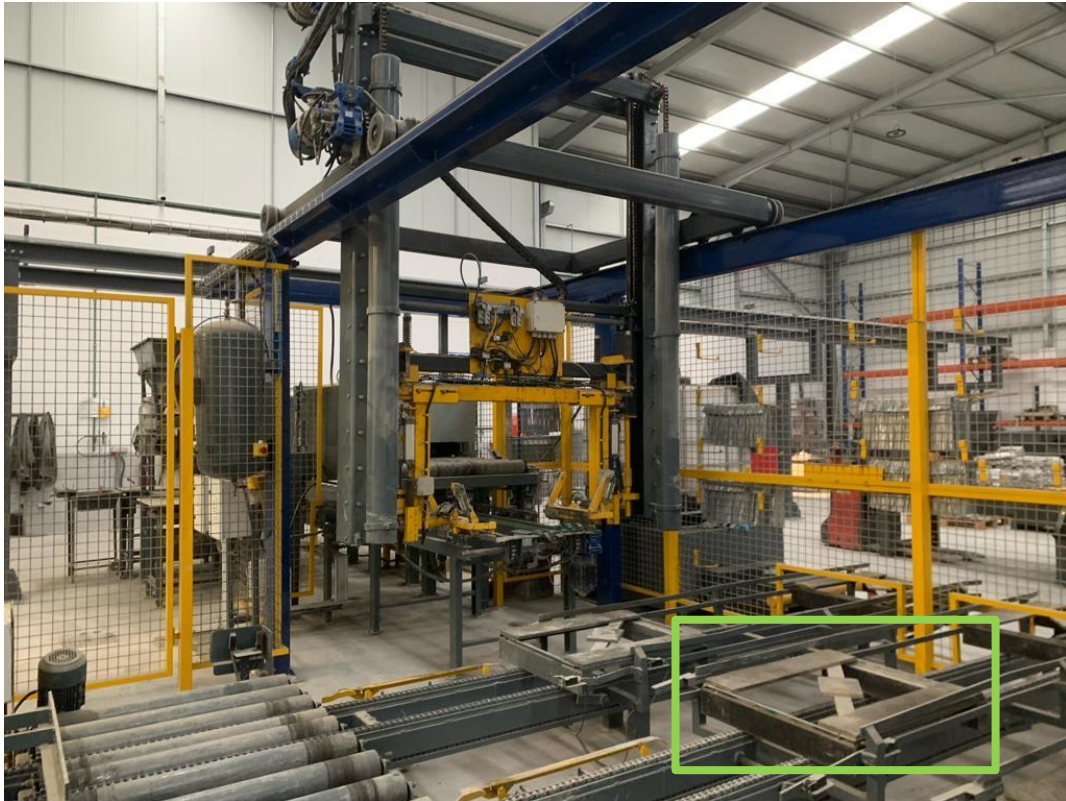
Figura 24 - Zona de Transportadores de Correntes
