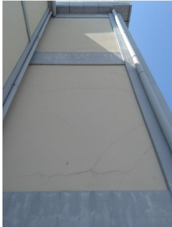
Figura 19 - Fissuração de revestimentos
