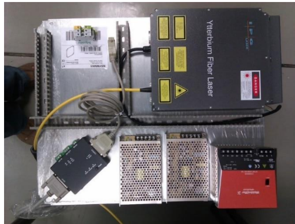
Figura 25 -Placa final do quadro elétrico
