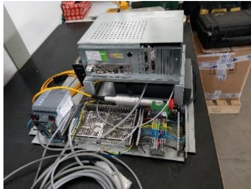
Figura 31 - Detalhe da Placa elétrica
