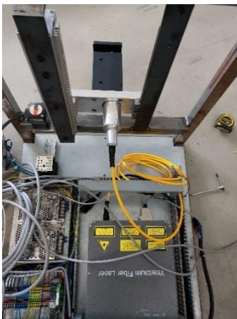
Figura 36 - detalhe da conexão da fibra ao eixo
