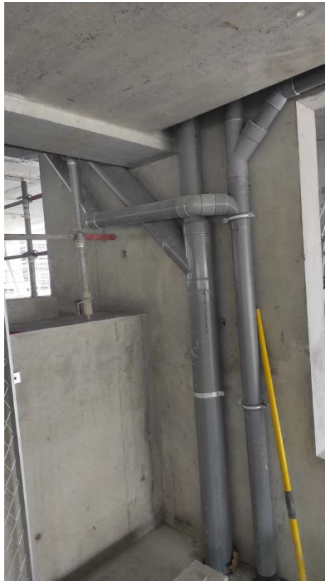
Figura 2 - Tubulação de águas pluviais (fonte: autor)
