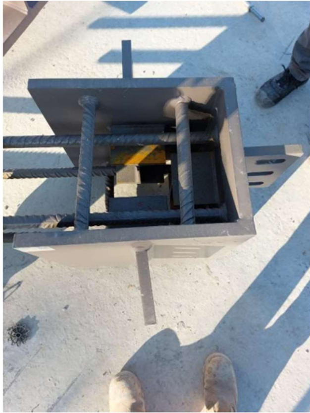
Figura 55 - Chumbador em obra (Fonte: Autor)
