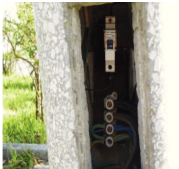
Figura 23 - Poste de luminária sem tampa
