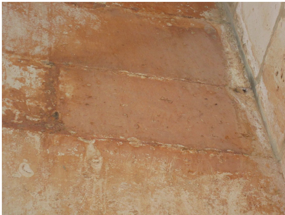
Figura 14 - Pátina no canto de um contraforte
