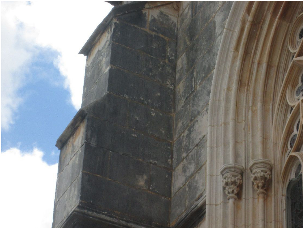
Figura 12 - Crostas negras da escorrência de águas no contraforte
