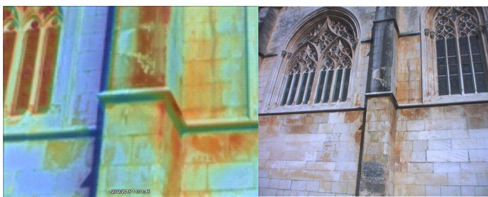
Figura 42 - Termografia das crostas negras e respetiva foto da localização
