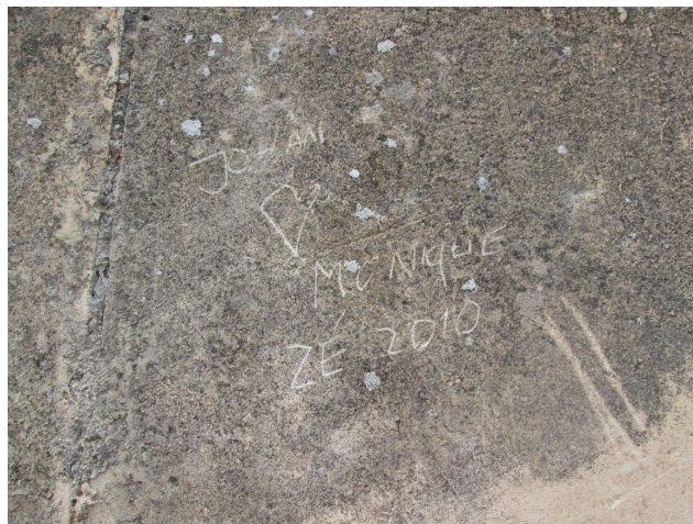
Figura 22 - Vandalismo nas pedras
