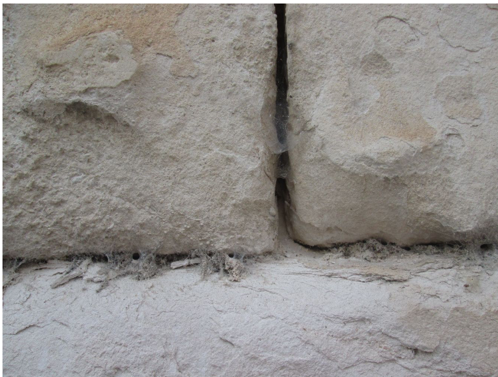
Figura 18 - Desagregação da pedra e da argamassa da junta
