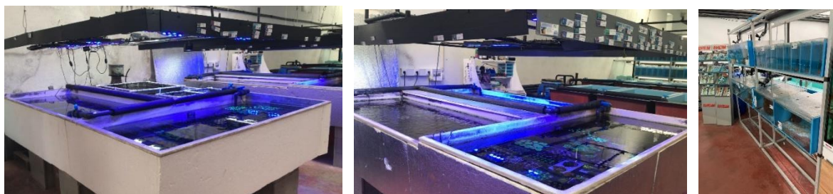
Figura 26- Tanques que constituem o Sistema dos Corais, assim como conjunto de baterias do rack dos crustáceos.
