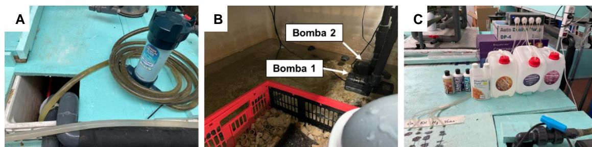
Figura 29- Sump do Sistema dos corais; A) Sump com reator de mídias com carvão ativado para filtração química; B) Interior da sump com a bomba 1 e a bomba 2 visíveis; C) Sump com linha de retorno para o rack dos crustáceos e bomba doseadora.
