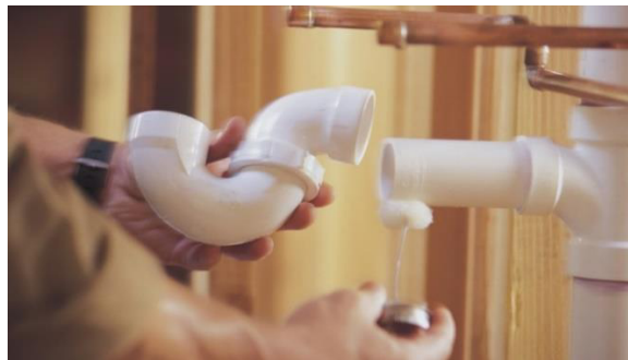
Fig. 24 Deficiencia en Instalaciones Sanitarias
