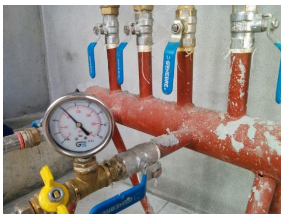
Fig. 31 Medición de presión en un circuito cerrado a través de un manómetro
