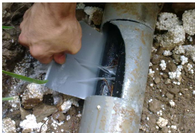
Fig. 30 Inspección visual de fuga de agua
