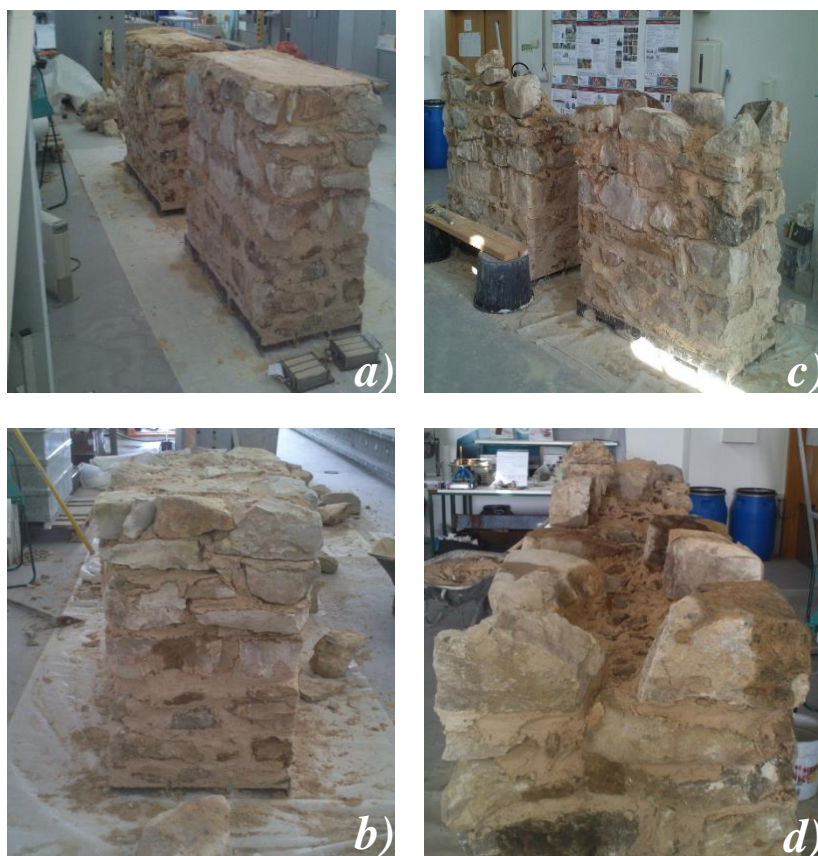
Figura 41 – Segunda fase de construção: a) alçados frontais; b) seção transversal; c) alçado frontal-colocação perpianhos; d) seção transversal-colocação perpianhos.
