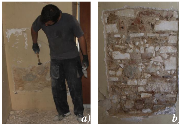
Figura 15 – Remoção da camada de revestimento: a) durante a picagem; b) depois da picagem.
