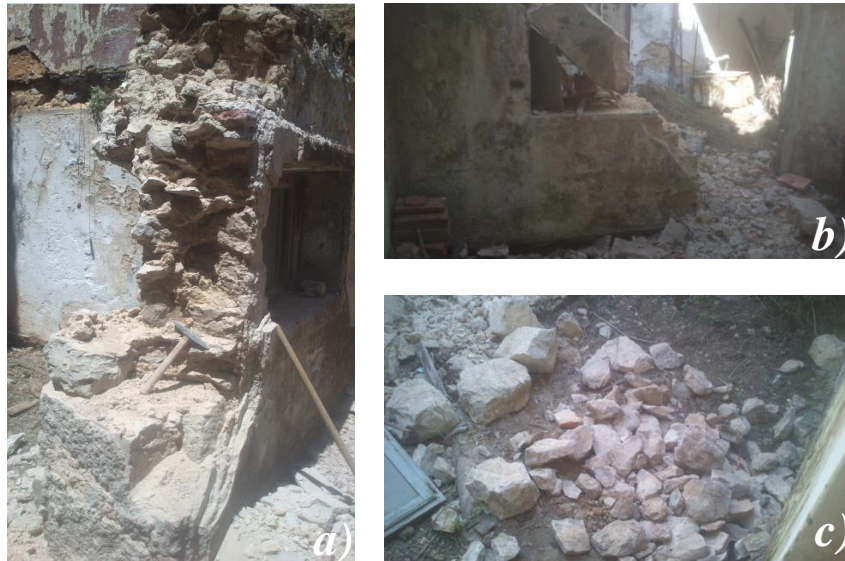
Figura 35 – Segunda fase de demolição da parede: a, b) demolição parcial da alvenaria de pedra; c) conjunto de amostras recolhidas após demolição.
