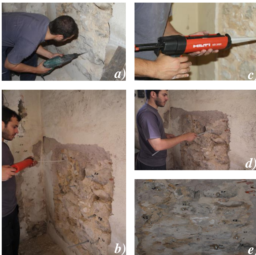
Figura 29 – Preparação dos ensaios de arranque: a) perfuração; b) limpeza dos furos; c) aplicação do químico; d) introdução das barras rosçadas; e) aspeto final da janela de inspeção antes de ensaio.
