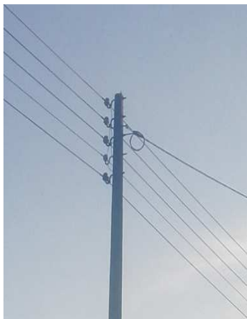
Figura 10 – Condutores nus dispostos em esteira vertical
