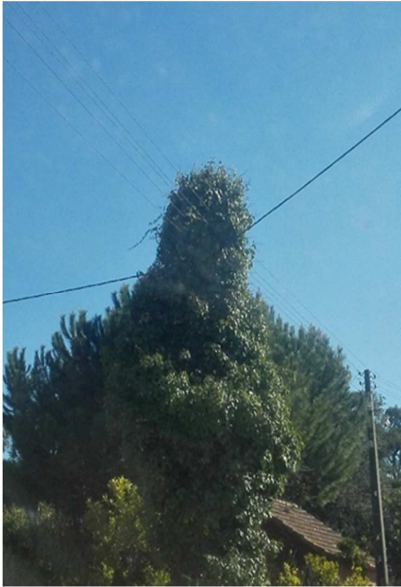
Figura 15 – Poste e condutores nus envolvidos por árvore
