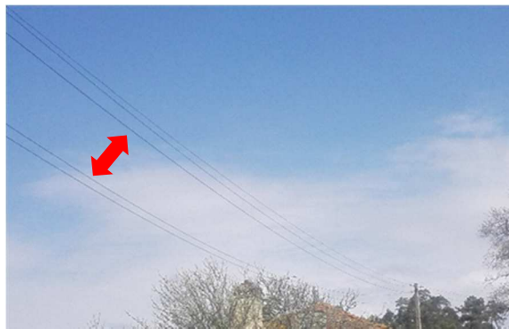
Figura 16 – Condutores nus desregulados
