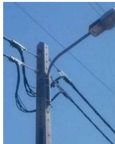
Figura 11 – Condutores isolados em torçada
