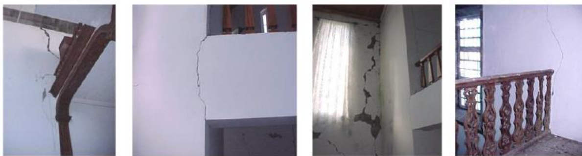
Figura 52 - Danos resultantes da interação entre coro alto e paredes laterais [27].
