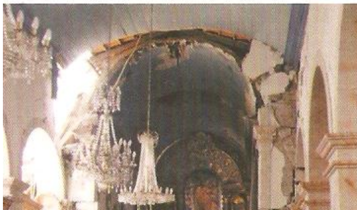
Figura 45 - Fendas nos arcos e danos na ligação das abóbadas com o arco – Mecanismo 7.
