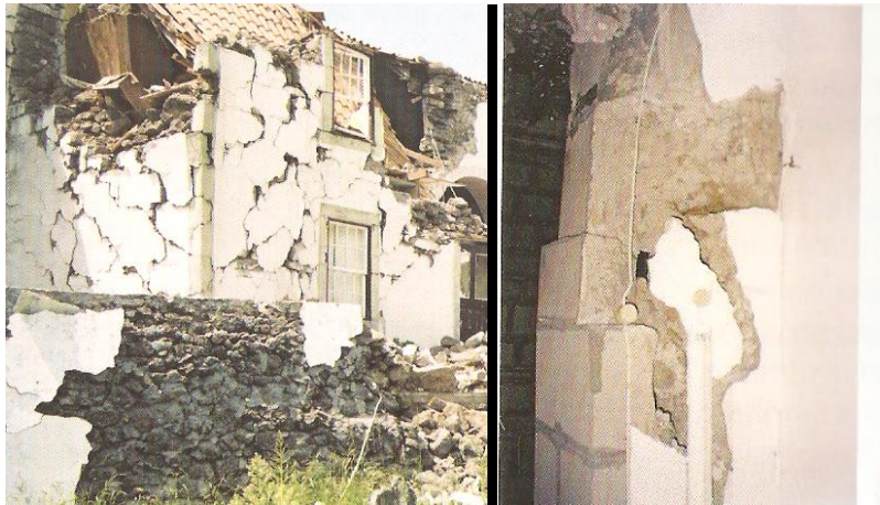
Figura 27 – Imagens de alvenaria de pedra após o sismo [21].
