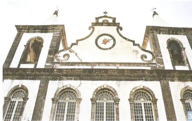
Figura 54 - Rotura do frontão da fachada [21].
