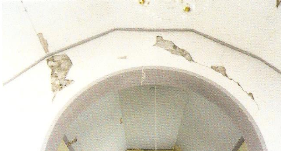
Figura 46 – Interação entre cobertura e paredes laterais – Mecanismo 19.
