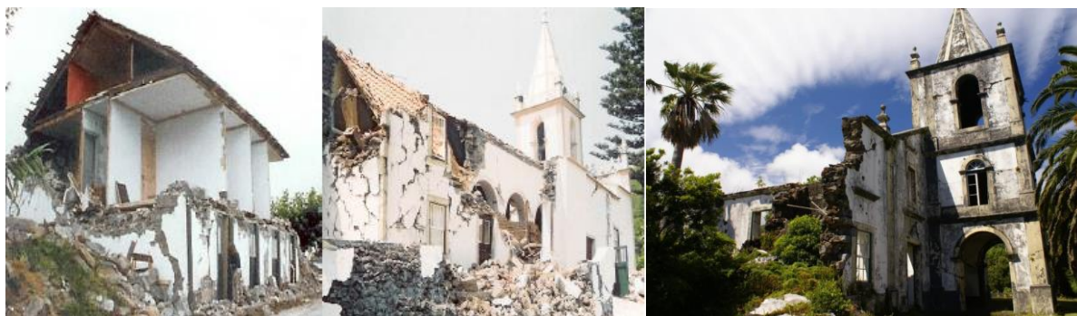
Figura 44 - Colapsos na estrutura [10].
