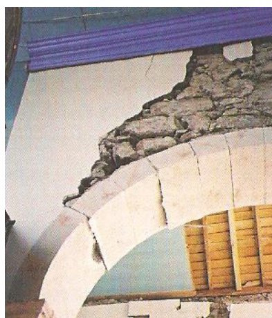
Figura 28 - Parede divisória interior danificada [21].
