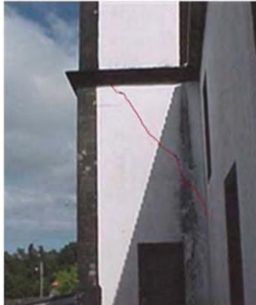
Figura 47 – Danos resultantes da interação entre torre e corpo principal da igreja, Igreja das Bandeiras [29].
