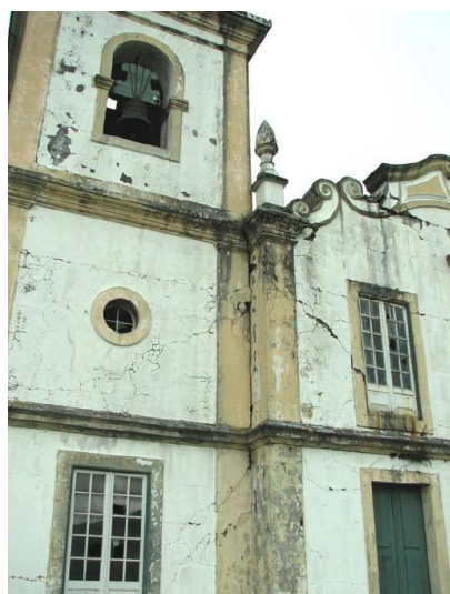
Figura 53 - Fenda vertical na ligação entre as paredes e a nave, fendilhação diversa e queda de reboco [24].
