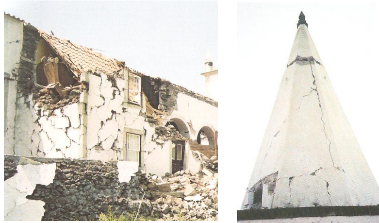
Figura 56 - Degradação das coberturas [21].
