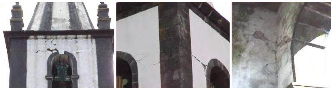
Figura 48 - Danos nos campanários, sismo de 1998: Igreja da Feteira e Bandeiras respetivamente [29].
