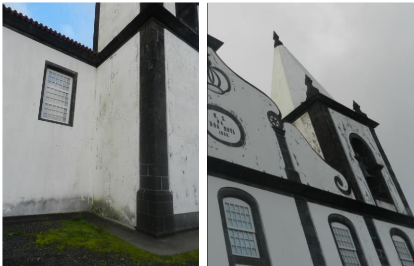
Figura 100 - Patologia relacionada com a humidade.
