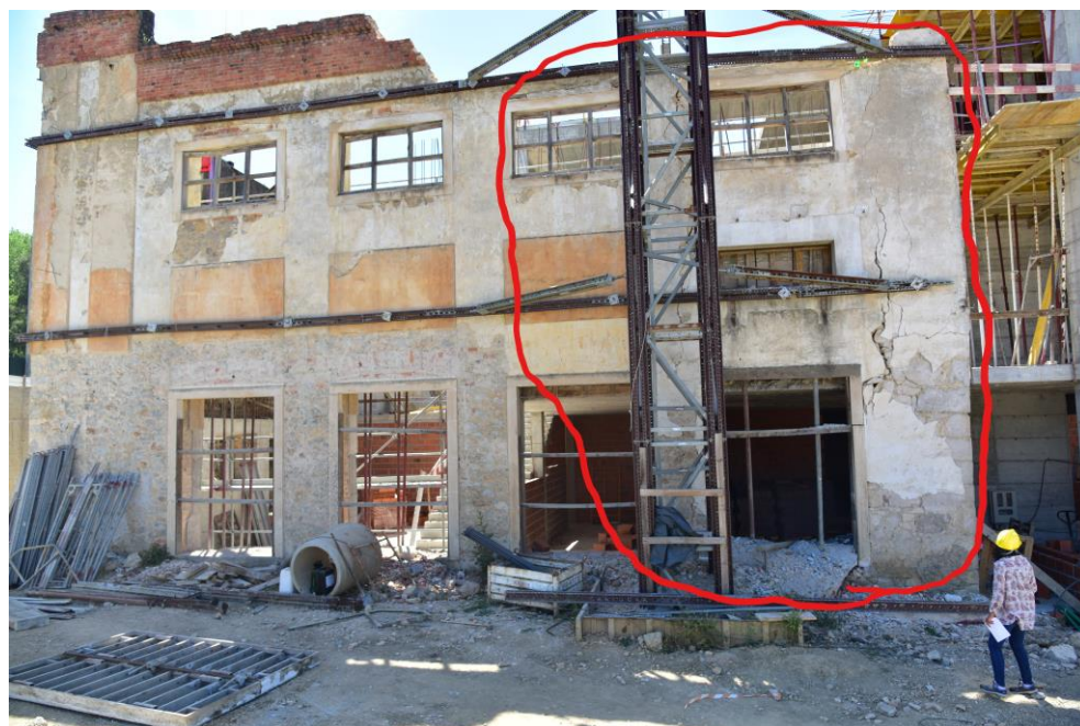
Figura 17 – Zona da parede afetada a desmontar e reconstruir com os mesmos materiais
