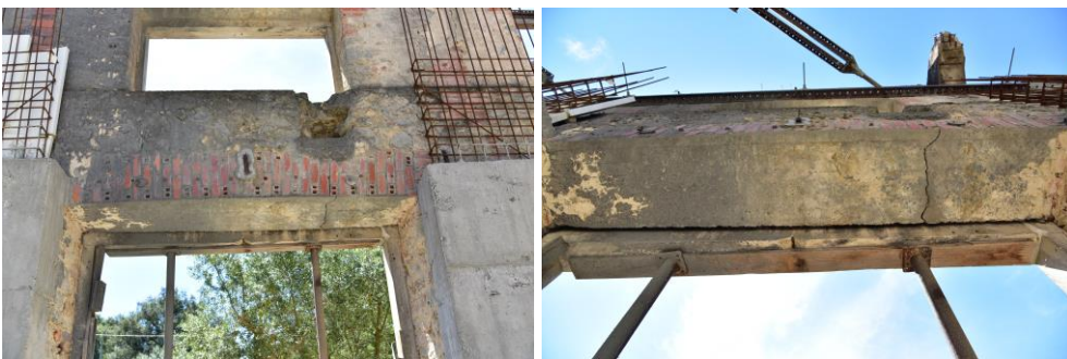
Figura 11 – Fissura em vão da fachada poente
