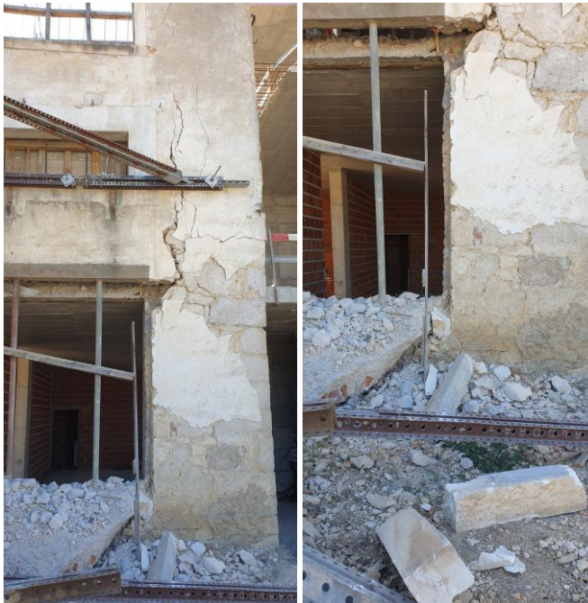
Figura 16 – Desmoronamentos recentes na parede afetada
