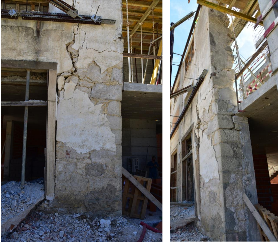
Figura 5 – Imagens do cunhal entre a parede nascente e norte à data atual
