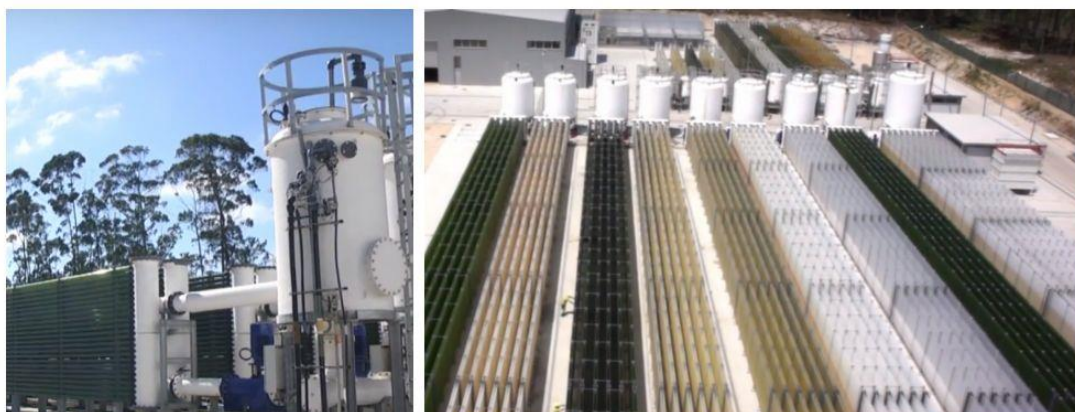
Figura 20- Instalação de produção industrial de microalgas em fábrica de cimento Secil [73].
