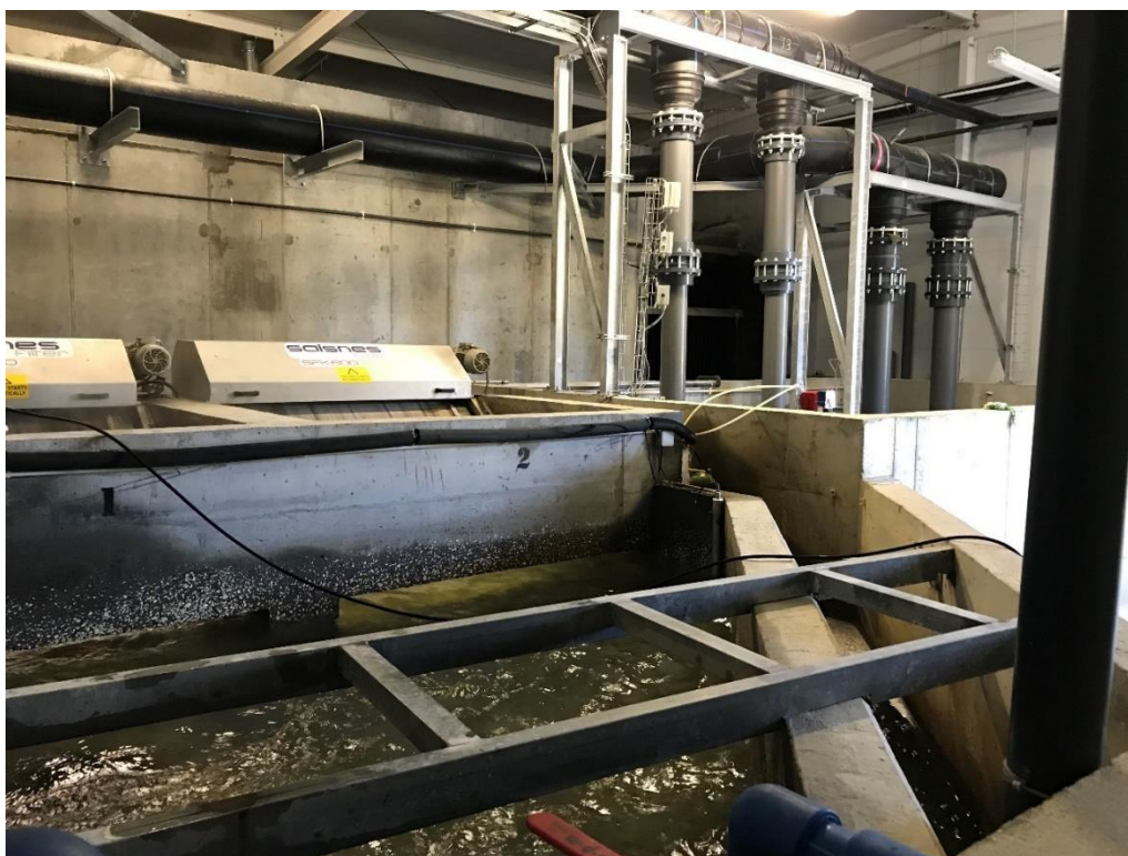
Figura 14 – Área de tratamento da água (RAS) de cultivo do módulo de pré-crescimento (Fonte: Empresa).
