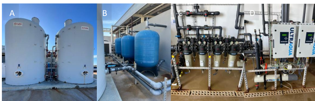
Figura 17 - Estação de Tratamento da água no exterior da maternidade. A. Reservatórios; B. Filtros de areia; C. Filtros de cartucho e D. Luzes Ultravioleta.
