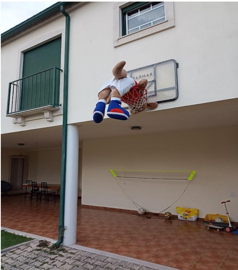
Figura 45. Se necessário, chame um técnico para extinguir o perigo...
