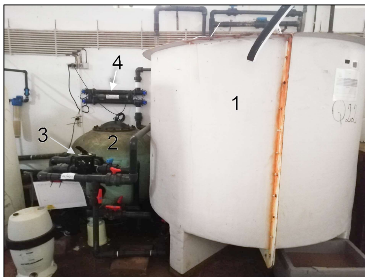
Figura 4.1-1 - Um dos sistemas dos tanques de grande porte da quarentena, neste caso o Q22. Neste caso, o tanque encontra-se equipado com aquecedor de titânio que fica em ligação direta no circuito da água, mas não se consegue visualizar na fotografia. 1 – Tanque; 2 – Filtro de Areia; 3 – Válvula Multiporta (Backwash, Recirculação, Esgoto); 4 – Filtro UV.
