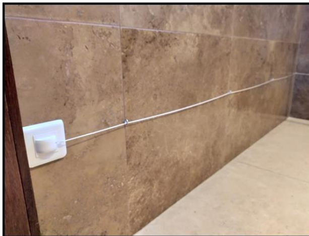
Figura 6: Fotografia do terminal do sistema de aviso
