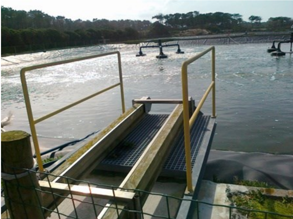
Figura 20 - Imagem geral, ETAR de Praia de Pedrogão (SIMLIS, 2008)
