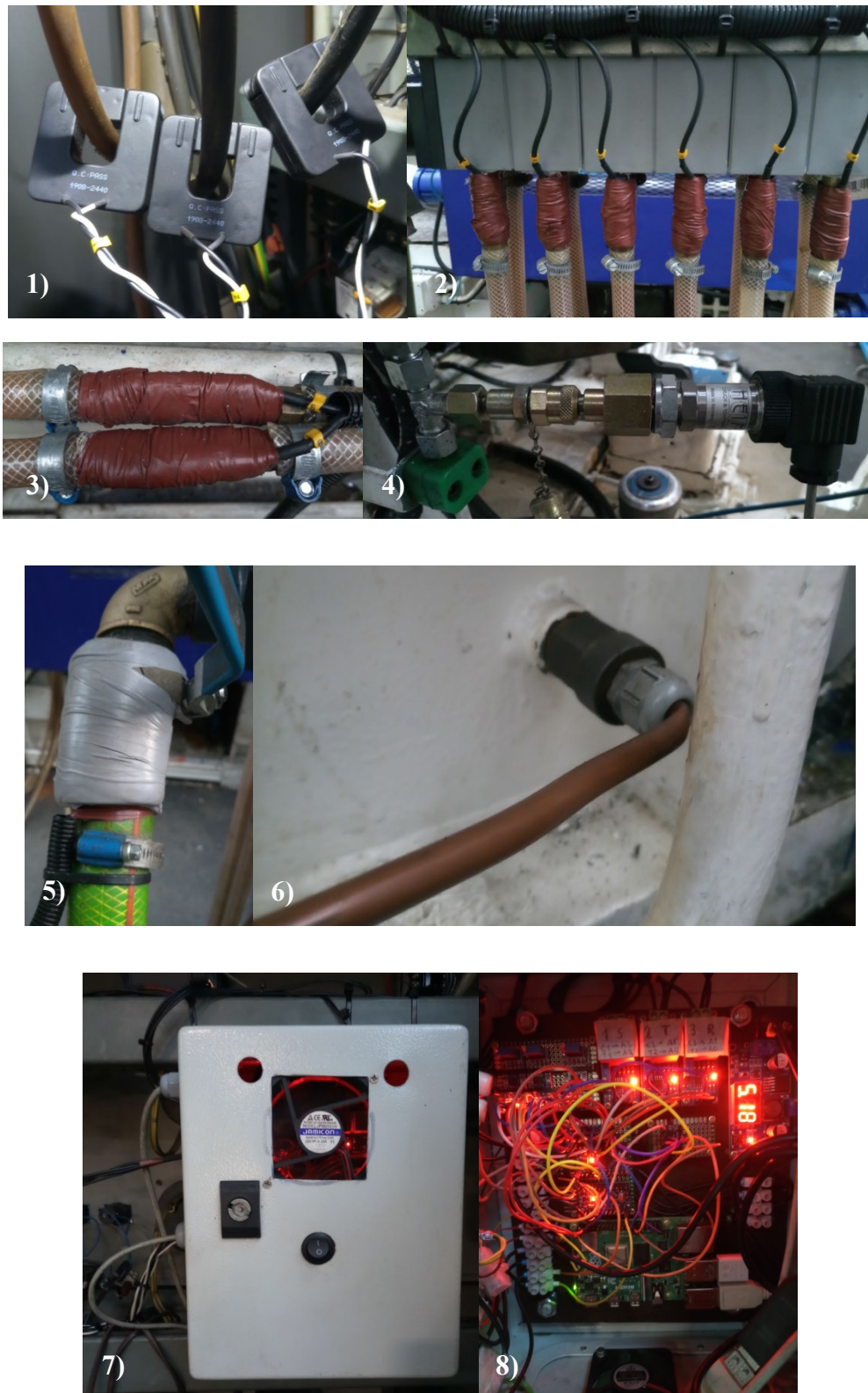
Figura 53 - Hardware instalado na máquina
