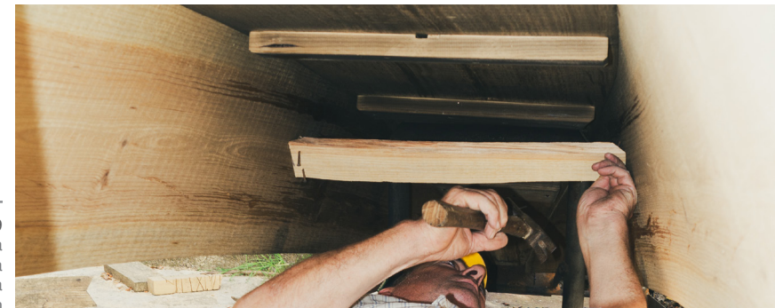
Figura A39 É pregada uma ripa de madeira na zona da dobragem
