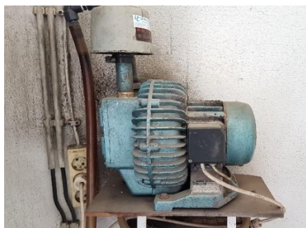
Figura 13. Compressor de ar montado no terraço do Torreão, AVG, 2020.
