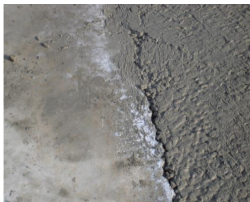
Figura 3- Aspecto de uma junta de betonagem onde é visível a diferença entre os betões de diferentes idades [5]
