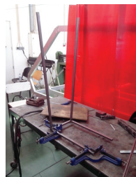
Estrutura da Extrusora.
