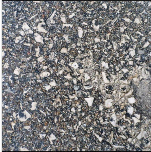
Figura 52 - Padrão do pavimento de estrada em asfalto irregular R3.
