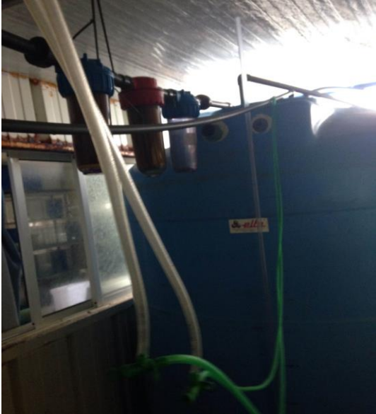
Figura 10: Depósito de água salgada e filtros primários para filtração da água da rede do Laboratório de Aquacultura.
