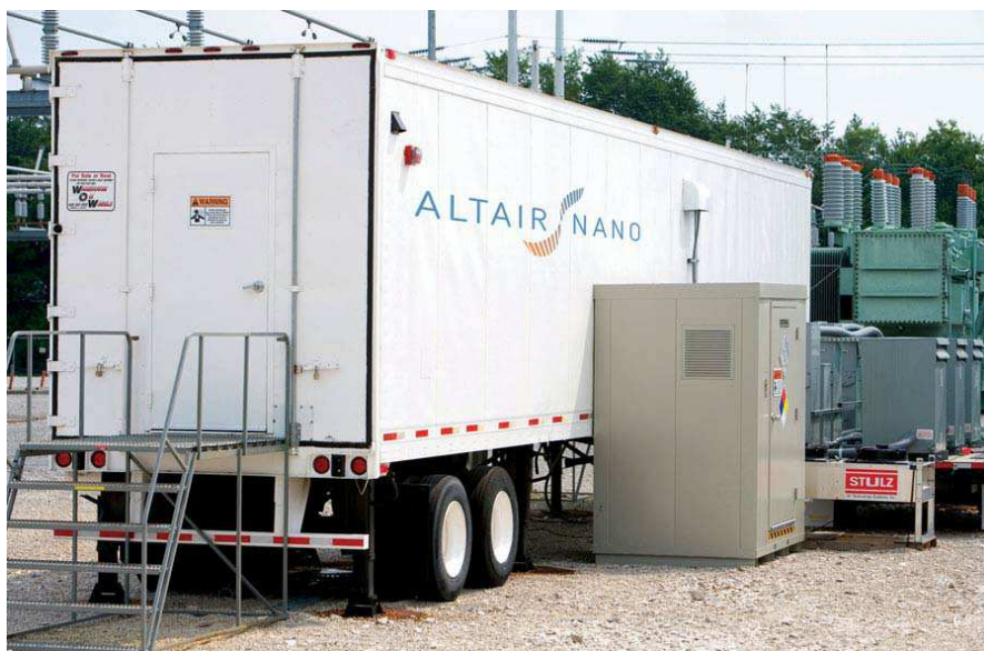
Figura 12 – Bateria móvel de íões de lítio [4].
