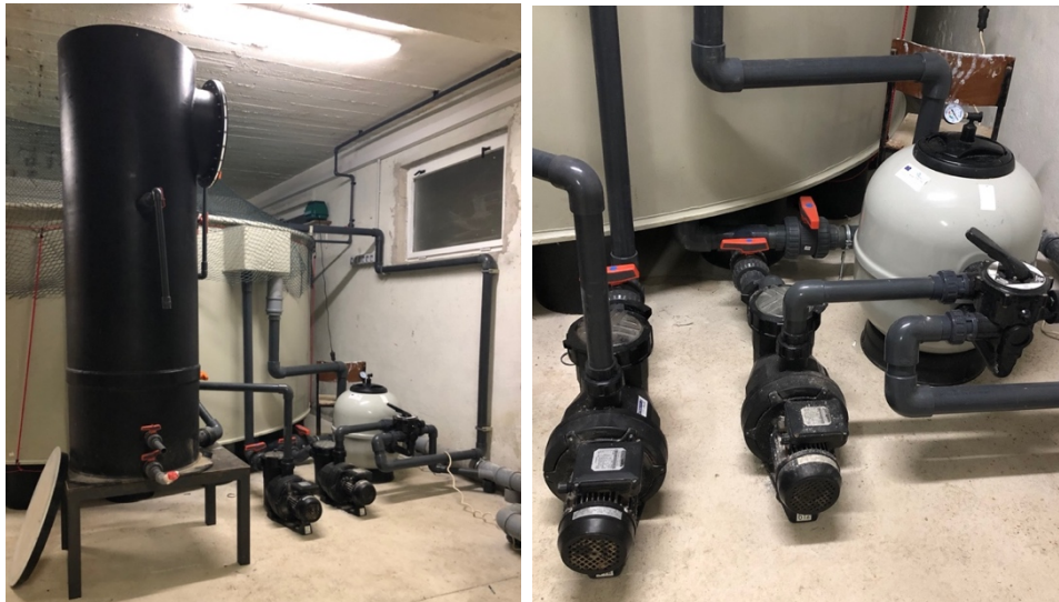
Figura 49 - Sistema do tanque circular da quarentena.
