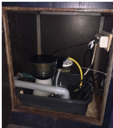
Figura 42 - Compartimento com sistema de filtração do aquário.
