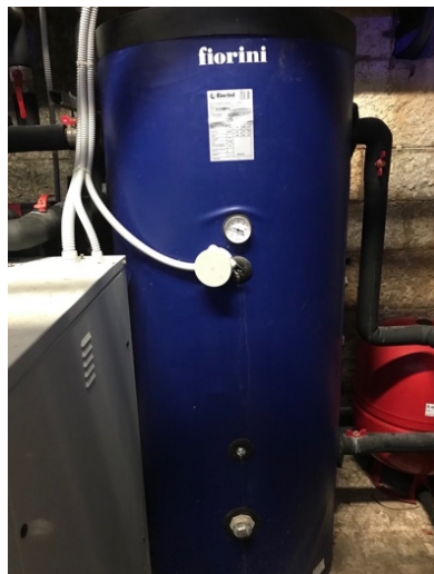
Figura 37 - Puffer de 500L conectado à bomba de calor.
