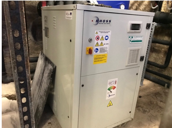
Figura 36 - Bomba de calor.
