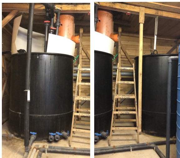
Figura 33 - Reservatórios de 5m 3 .
