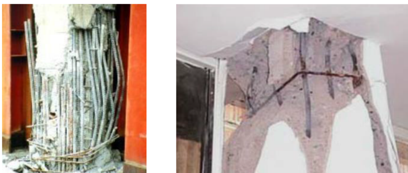
Figura 2.2 – Pormenorização deficiente das armaduras [10] e [11]
