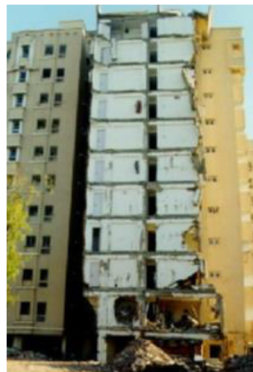
Figura 2.4 – Danos num edifício irregular em planta [12]
