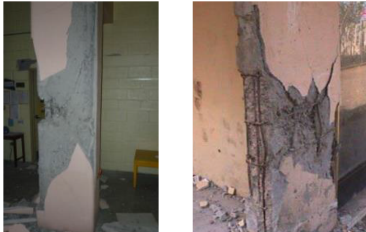
Figura 2.7 – Insuficiente capacidade ao corte [17] e [18]
