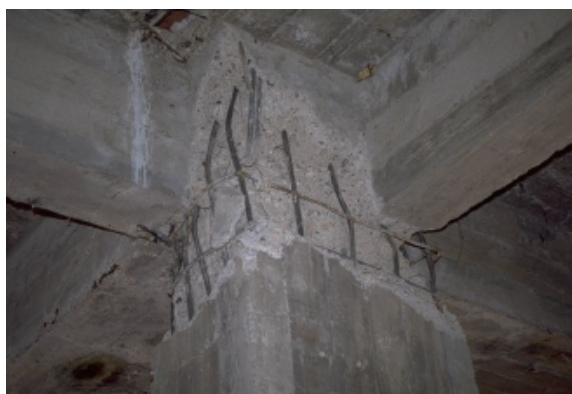
Figura 2.8 – Capacidade insuficiente dos nós viga-pilar [1]
