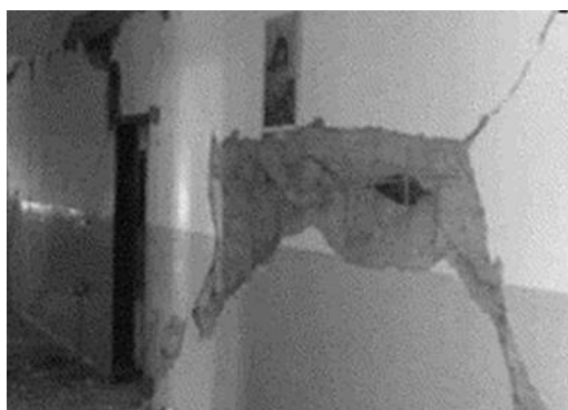
Figura 2.6 – Danos em parede de betão armado [16]
