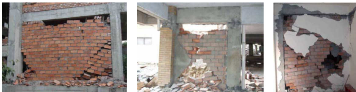
Figura 2.14 – Separação dos painéis de alvenaria de enchimento e a estrutura de betão armado, a), com concentração de danos na alvenaria, b) e c), com concentração de danos na alvenaria e na estrutura confinante [27]
