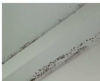
Figura 22 - Fotografia do tecto da cozinha com presença de sinais de humidade
